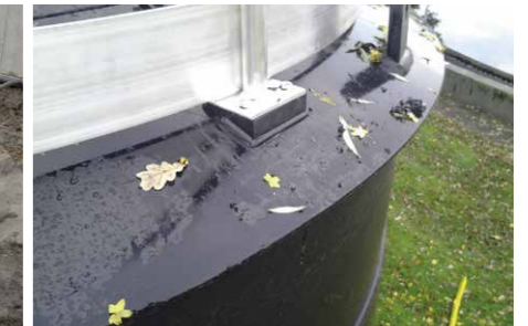
PE-HD voorziening t.b.v. RVS steunen op tanks
